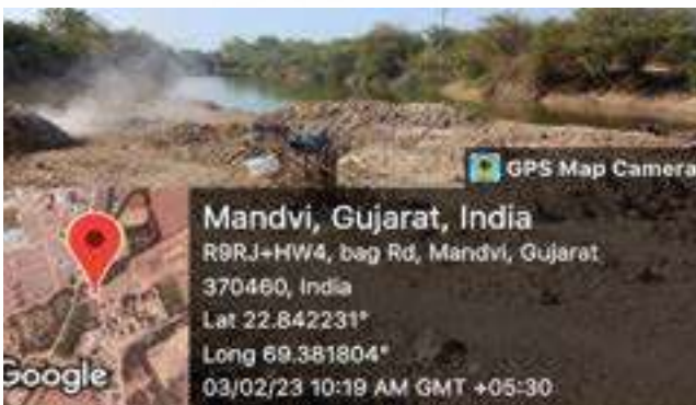
GP : Maska Structure : Recharge Trench
